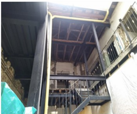
Fotografía 11. Vista desde el interior del patio central del inmueble de la localizado en la CL 11 8 68 / 70 / 72 / 76. (fecha de captura de la imagen: 2022-10-07)
