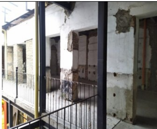
Fotografía 12. Vista del segundo piso, hacia el corredor perimetral del patio central del inmueble de la localizado en la CL 11 8 68 / 70 / 72 / 76. en donde se observan cambios de acabados generales, retiro de carpinterías, y cambio de instalaciones técnicas. (fecha de captura de la imagen: 2022-10-07)
