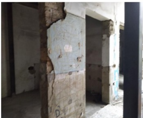
Fotografía 13. Detalle del estado de muros del segundo piso del inmueble de la localizado en la CL 11 8 68 / 70 / 72 / 76, no se puede establecer si esta condición es reciente. (fecha de captura de la imagen: 2022-10-07)
